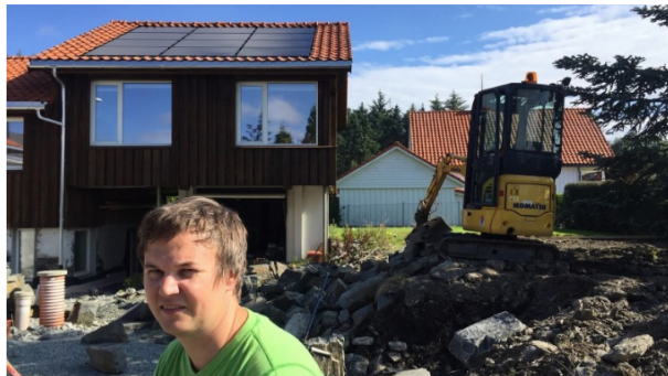
Petter Dahle Melhus har valgt en løsning hvor solpanelet er innfelt i taket. Han planlegger å skifte ut takpannene til samme farge.
